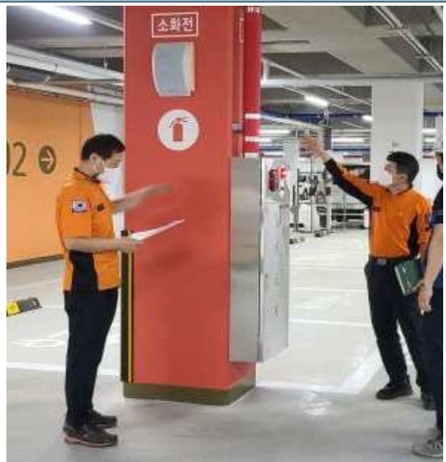
소화전 및 소화기 설치 위치 색상 표시 예시
